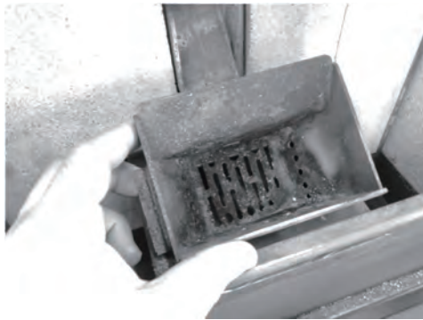
燃焼ポットの確認
